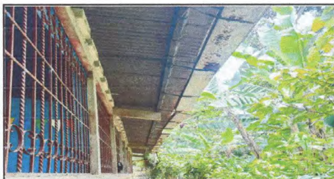
Foto 5: Sustrucción de canales de metal y caída de agua
